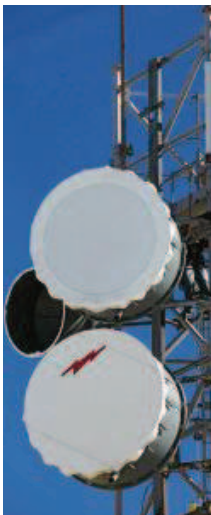
Circet est spécialisé dans l'installation de pylônes pour la téléphonie mobile. Photo DR
